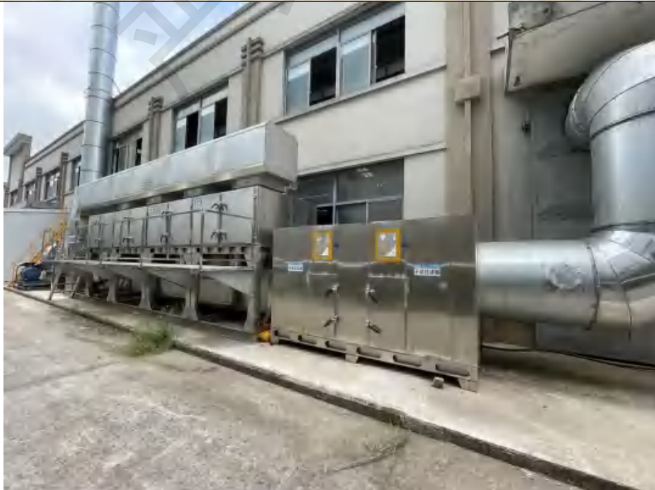
五级干式过滤装置+活性炭吸附-脱附催化燃烧装置（涂装工序处理设施、活性炭填装量 5m 3 ）
