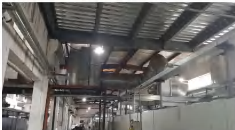
图 4-3 废气处理设施
