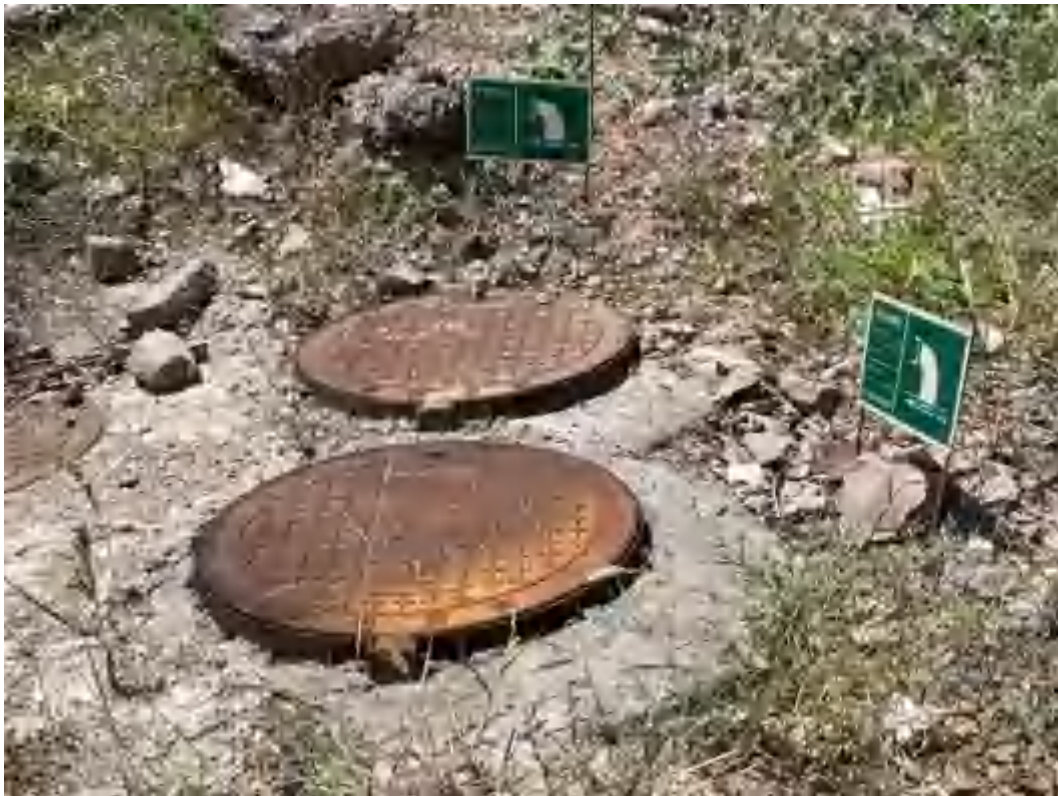
图 3-6 废水和雨水排放口图
